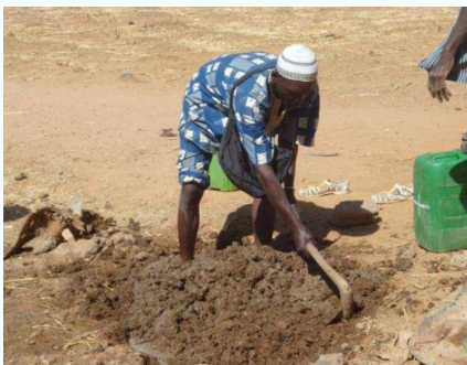
4. Un mélange de banco avec la bouse de vache est préparé pour couvrir la fosse.
